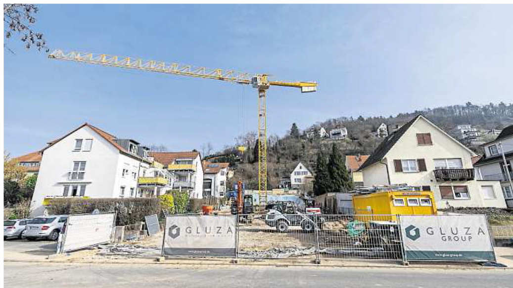
4500 Kubikmeter Erde wurden für die „Starkenburger Terrassen“ bewegt.
